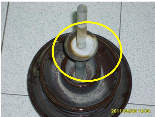
Fotografía 3. Aislador con Descarga tipo arco
