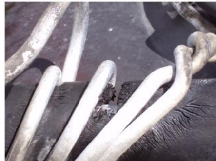
Fotografía 5. Cable Semi-aislado con Tracking
