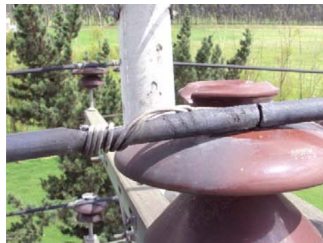
Fotografía 5. Cable Semi-aislado con Tracking
