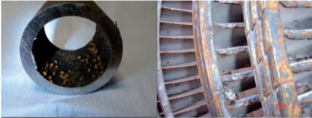
Fig. 7. Ejemplos de deficiente conservación de un tubo de condensador y de una turbina de vapor.
